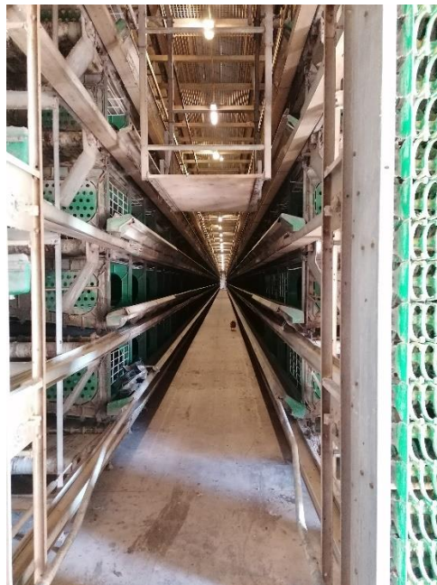
Figura 6.6 – Vista das baterias instaladas nos pavilhões de postura
