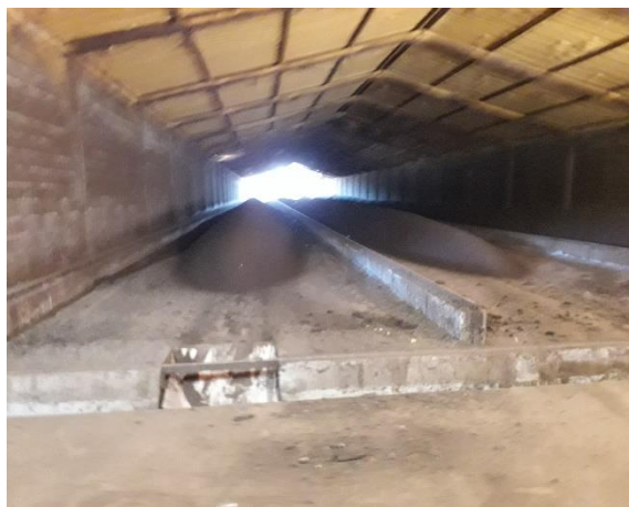
Figura 7.30 – Interior da unidade de compostagem
