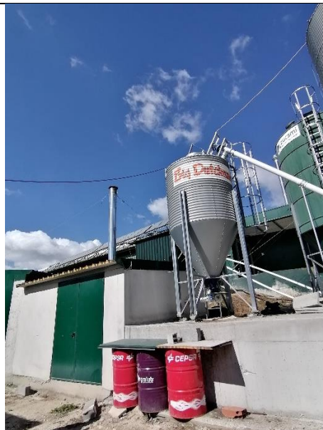
Figura 6.8 – Casa da Caldeira existente na instalação avícola, junto ao núcleo da Recria
